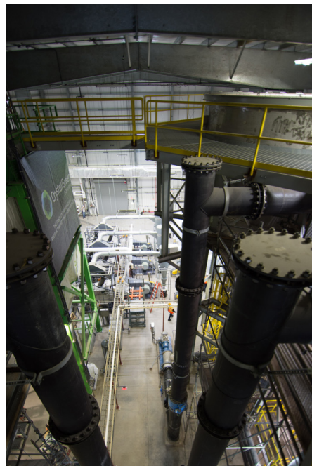
Instalacja odzyskiwania składników odżywczych MWRD z trzema olbrzymimi reaktorami może odzyskać ponad 85 procent fosforu i do 15 procent azotu z wody oczyszczonej przez zakład.
